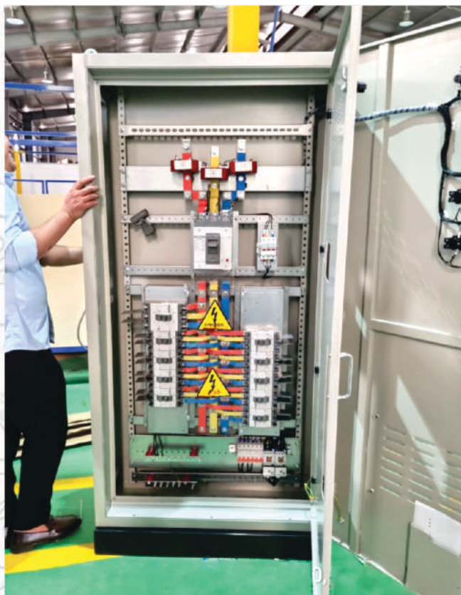
Cung cấp tủ điện cho Công ty CP Đầu tư DIC Providing electrical cabinets for DIC Investment Joint Stock Company
