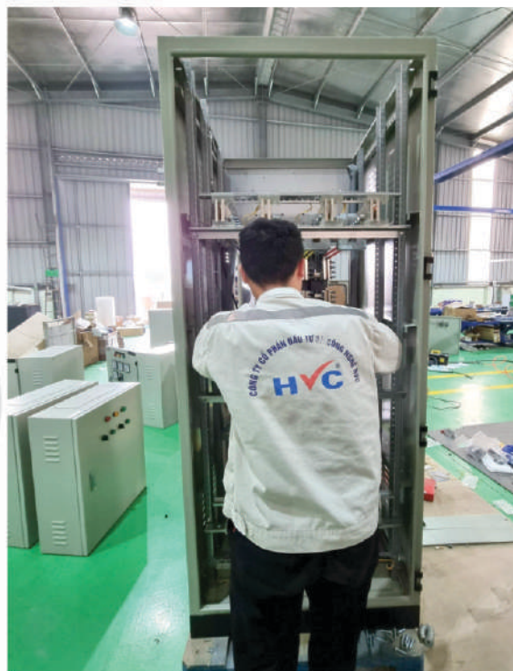
Tủ điện khách hàng đặt tại Quảng Ngãi Customer electrical cabinets at Quang Ngai
