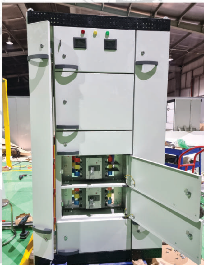
Dự án trạm sạc Tây Mỗ Tay Mo charging station project
