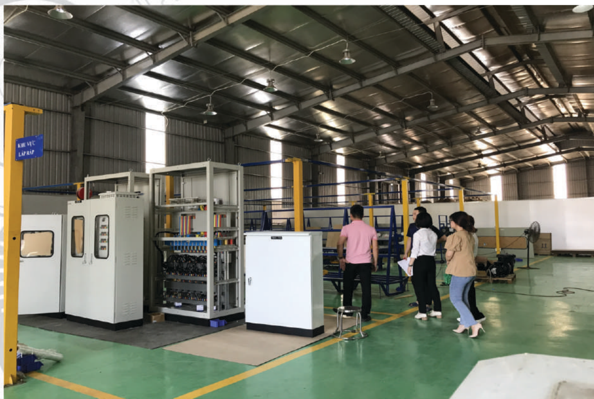
Tủ điện tại HVC Hưng Yên được kiểm tra chất lượng ISO Electrical cabinets at HVC Hung Yen are tested for ISO quality
