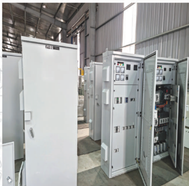
Dự án Trạm sạc tại Hà Tĩnh Charging station project in Ha Tinh
